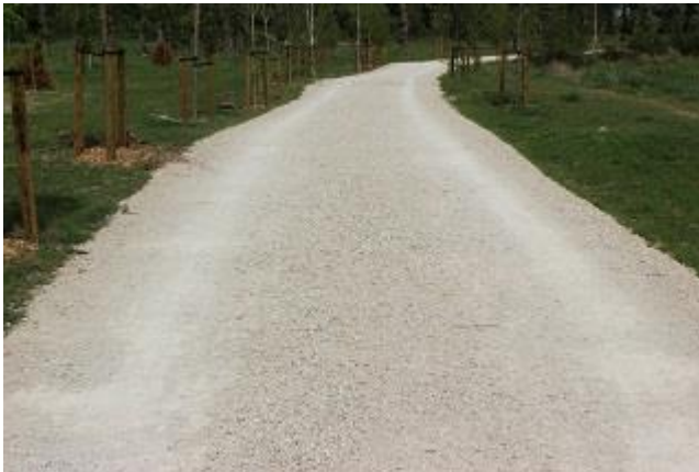
Tramo sin capa de arena fina
